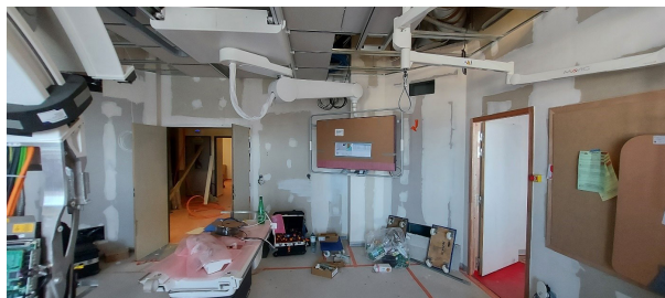
1/ L'accès au chantier par l'extérieur 2/ Livraison et installation du matériel 3/ Les travaux dans la nouvelle salle
